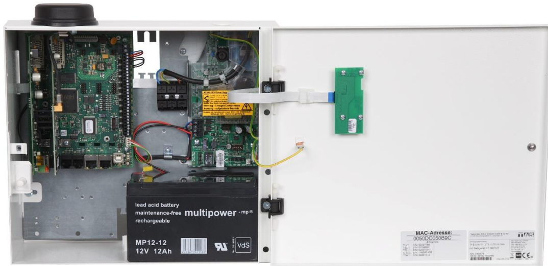
Abbildung 3 Innenansicht mit neuer Anschluss-technik
